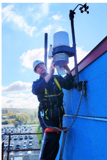
Обслуживание метеостанции до реализации ППУ
