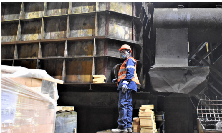
Металлический кожух хлоратора
