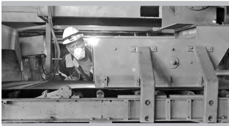
Настройку весов-дозаторов проводит М.Д. Мельков, цех № 16
