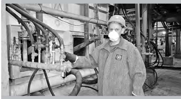
Александр Носков настраивает систему охлаждения электродов
