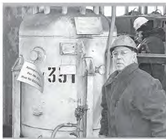
У разрядной ёмкости пневмоимпульсной очистки хлоропроводов — Н.Н. Зубков, бригадир хлоропроводчиков
