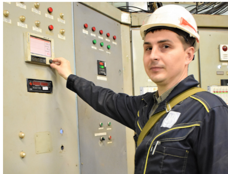
«Как идёт процесс, видим только по убыванию уровня на приборе учёта в щитовой», – показывает Евгений Харитонов
