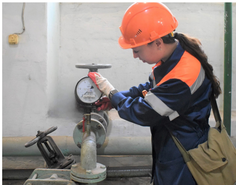
Меняет манометр в котельной слесарь по КИПиА Диана Сурсыкова (цех № 16)
