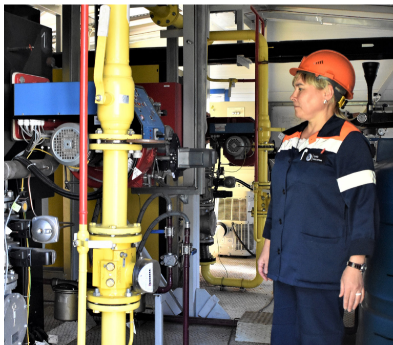
Отслеживает параметры работы котельной оператор Елена Приданникова (цех № 19)
